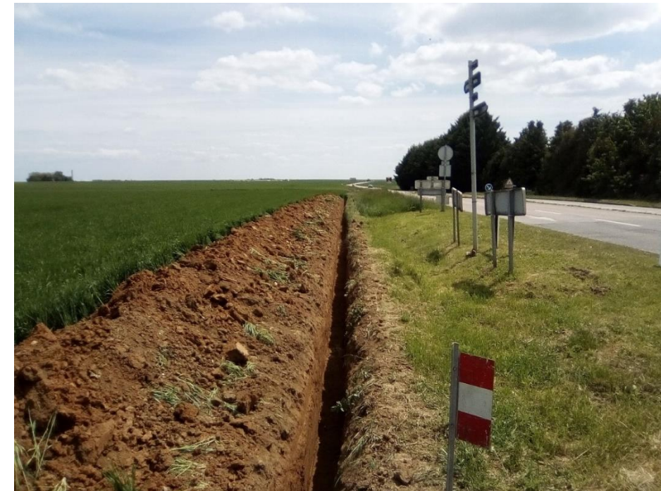
Photo 1 : tranchée pour le passage de réseau électrique HTA à partir d'une pelle
